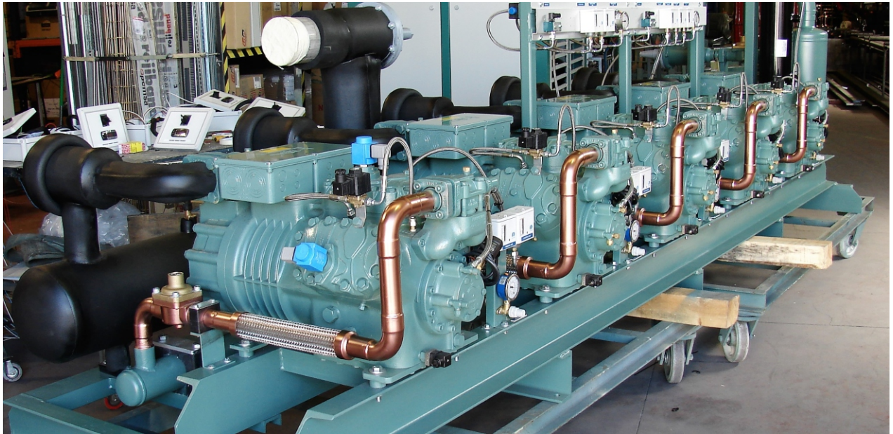
CENTRAL FRIGORIFICA DE 5 COMPRESORES BITZER ACP 5 X 6HE-28Y. (-10°C/ +45°C) R 134A. Pot. frigorífica = 168 kW
