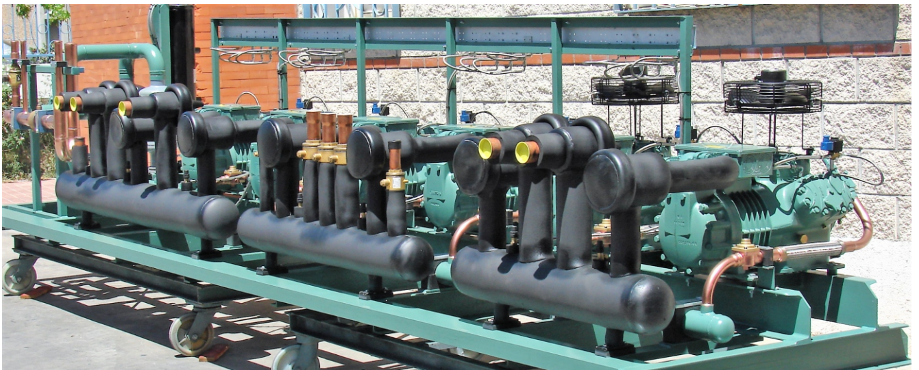
CENTRAL MULTI-ASPIRACIÓN DE 3 TEMPERATURAS CON COMPRESORES BITZER ACM 2 X 6JE-33Y + 2 X 6HE-28Y + 2 X 6FE-44Y (-30°C/-15°C/0°C // 45°C) R 449A, Pot. f = 69 kW + Pot. f = 85 kW + Pot. f = 230
