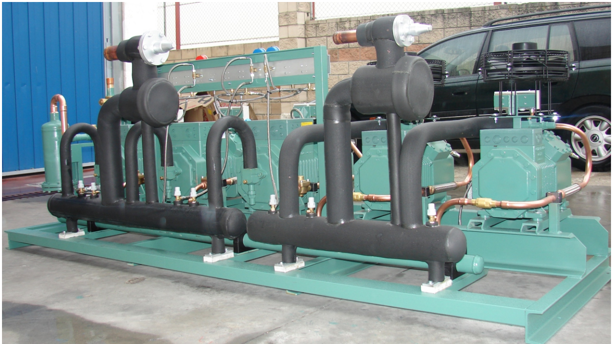
CENTRAL MULTI-ASPIRACIÓN DE 2 CON COMPRESORES BITZER ACM 2 X 4VES-7Y + 3 X 4 TES-9Y (-30°C/-15°C// 45°C) R 449A, Pot. f = 9,66 kW + Pot. f = 46 kW
