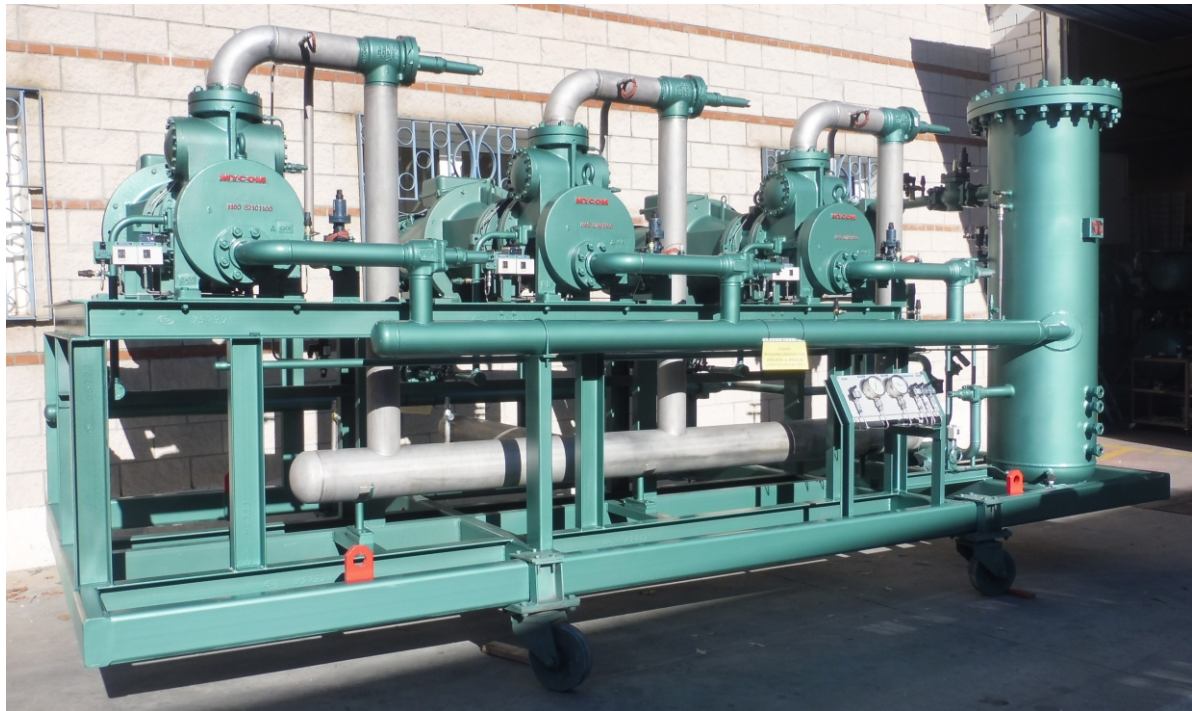
CENTRAL DE NH3 CON 3 COMPRESORES MYCOM CON SEPARADOR DE ACEITE ARCTIC
