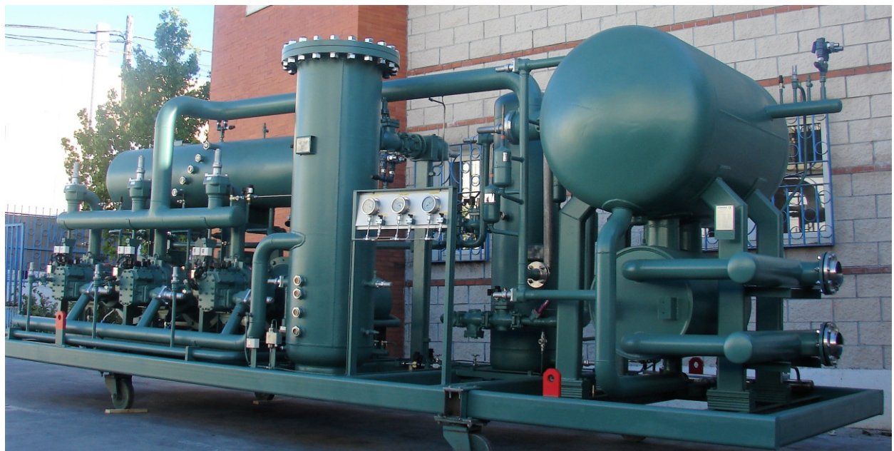
CENTRAL ENFRIADORA DE NH3 CON 3 COMPRESORES BITZER PARA GLICOL POR GRAVEDAD
